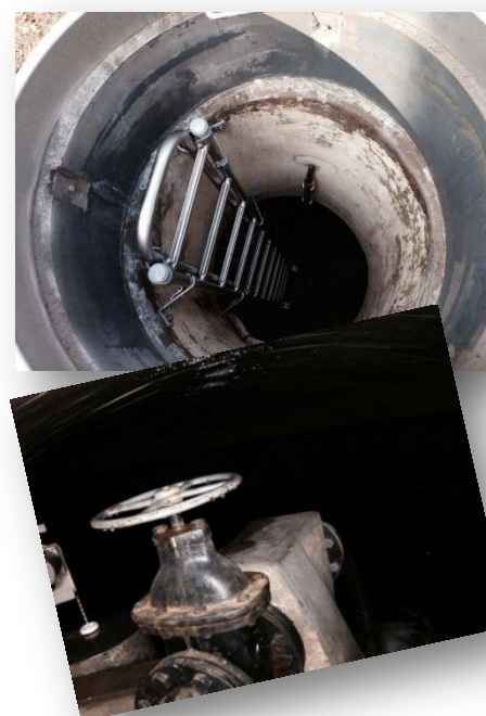
Photos : Réservoir de Vernand
